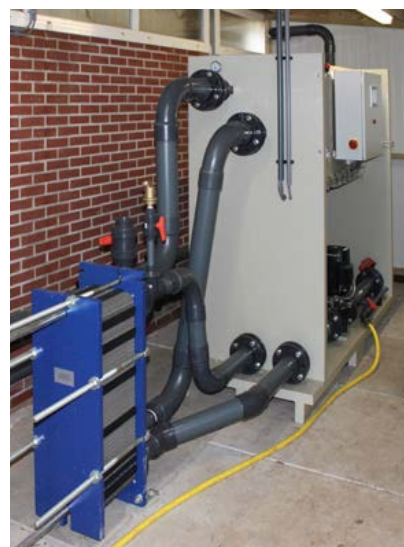
De Triple EEE-installatie bij de luchtwasser. Vooraan de blauwe warmtewisselaar.
